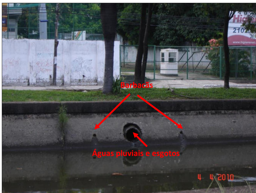
Figura 71: Lançamentos de Drenagem e de Esgotos no Canal Derby-Tacaruna
