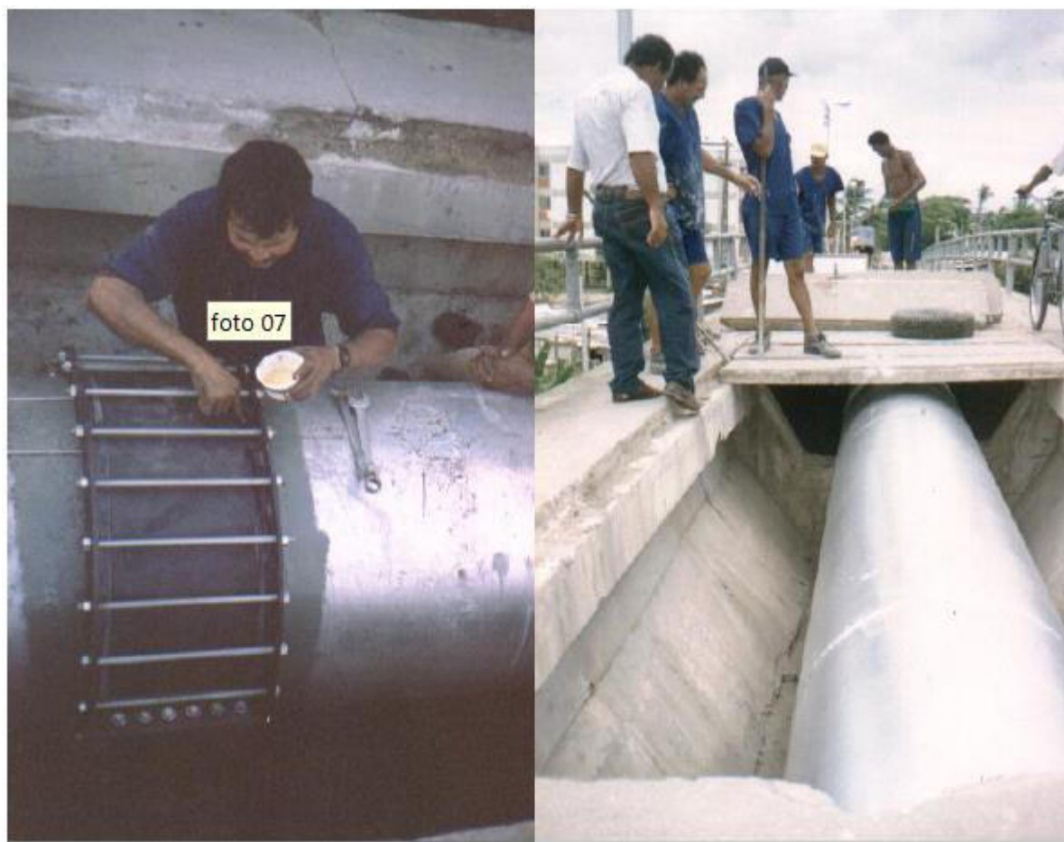
Figura 15: Sistema Permanente de Manutenção dos Grandes Anéis de Distribuição da Rede do Recife – Alça Norte DN 800 mm – Travessia sobre o Rio Capibaribe em Monteiro – Recife.
